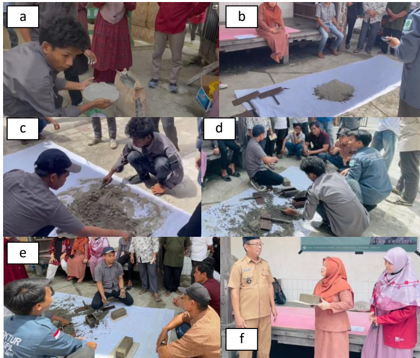
Figur 6. Proses pelatihan pembuatan bata beton: (a) Timbang bahan, (b) Siapkan dan campur bahan semen dan pasir, (c) Campur semen, pasir dan air hingga homogen, (d) Cetak bata beton secara manual, (e) Buka cetakan bata beton, (f) Bata beton segar
