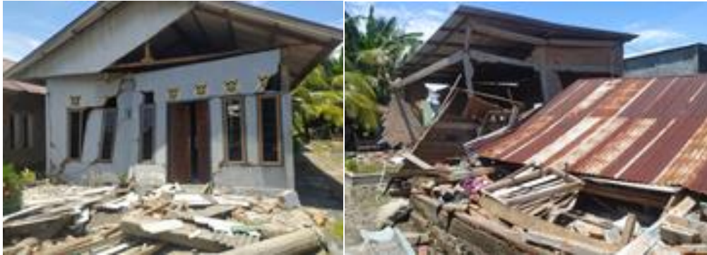
Figur 2. Kerusakan berat beberapa rumah di Desa Mekatta, Kabupaten Majene
