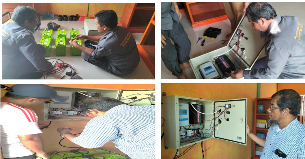
Figur 6. Instalasi PLTS pada mitra
