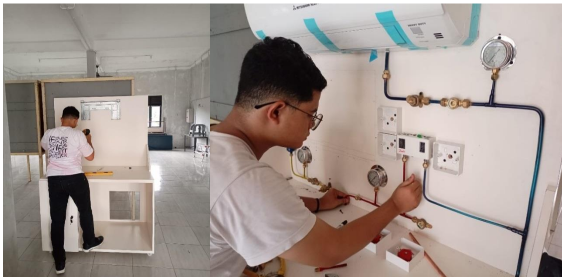
Figur 3. Rangkaian Simulator: (a). Perakitan Trainer Simulator dan (b). Instalasi Sistem Kelistrikan
