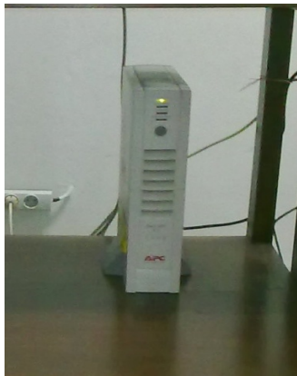
Gambar 20 UPS yang Digunakan
