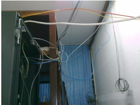
Gambar 19 Instalasi Kabel yang Tidak Rapi
