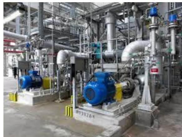
Gambar 1. Pompa pada Industri
