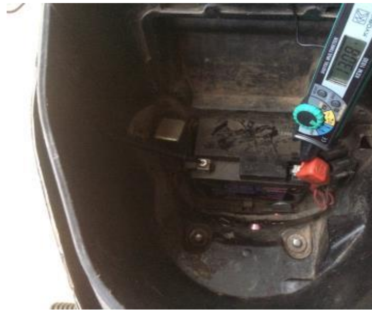
Gambar 4.1 Pengukuran Tegangan Pada Aki
