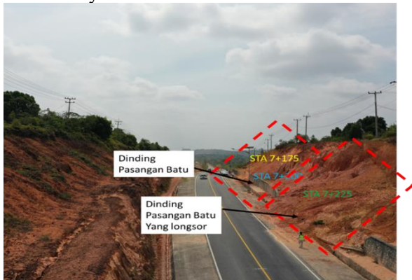
Gambar 1. Kejadian Longsoran Pada Lokasi Proyek
