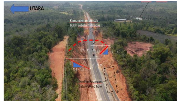
Gambar 2. Deskripsi Kejadian Longsor pada lokasi proyek (Sumber : Satker P2JN Kepri, 2021).
